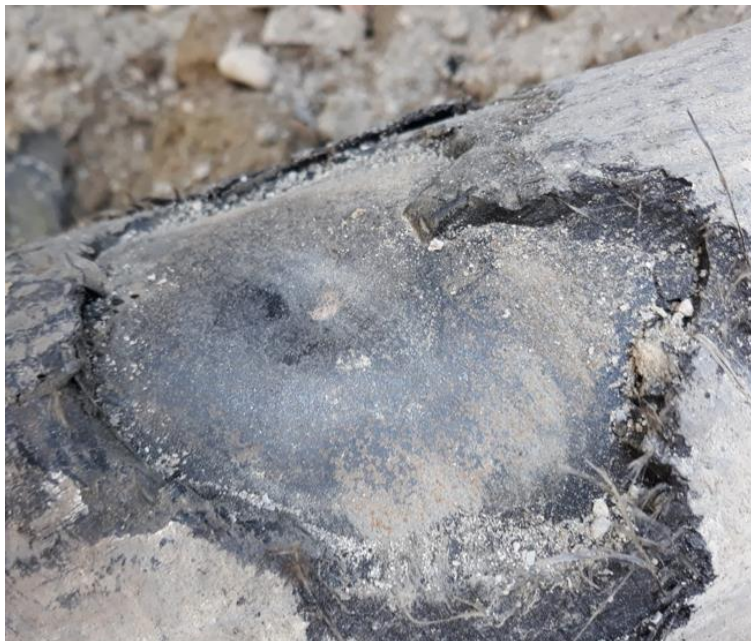
Fig. 29 - Il danno del picchetto sulla rete gas
