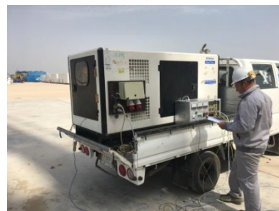
Figura 13 – Generatore diesel utilizzato
