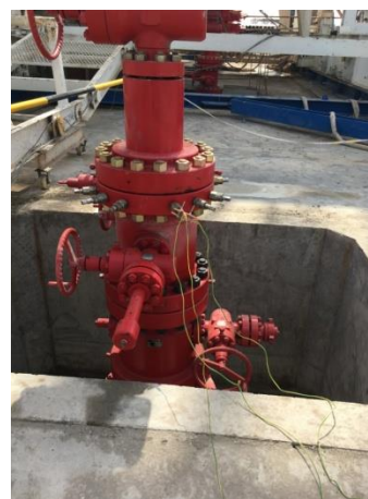
Figura 15 – Connessione cavi al testa pozzo relativa al casing Testato (100m)
